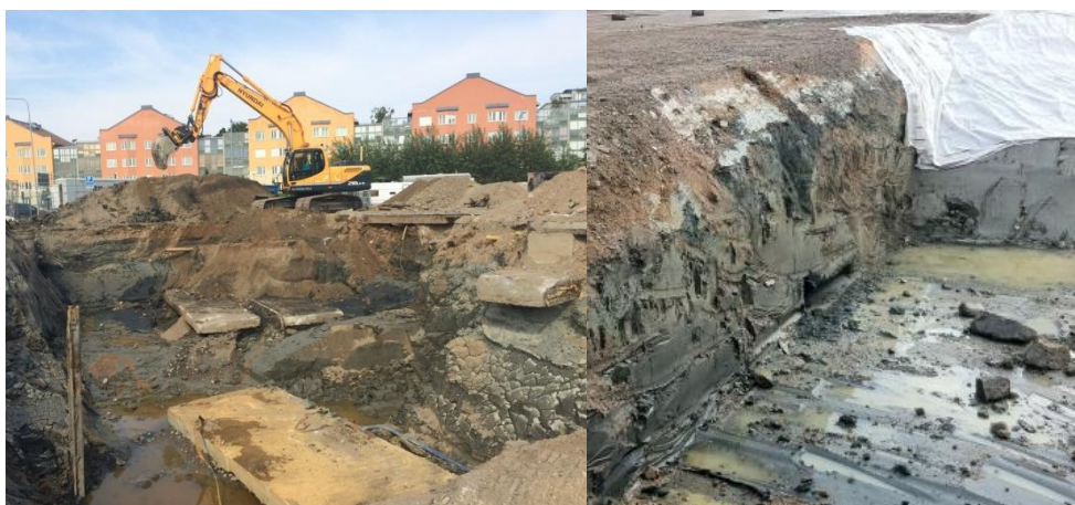
Figur 6. Bilden t.v. visar schaktgropen efter cisternlyft samt tillhörande bottenplattor. Bilden t.h. visar delar av gropen i anslutning till cisternerna på djupet 4-4,5m dvs den nivå där bensenförorening avtog.
