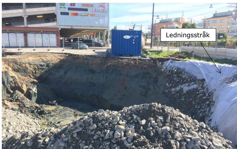
Figur 16. Bilden visar delar av område där restförorening kvarlämnats intill ledningsstråk i fastighetens sydvästra område. Fiberduk har lagts mellan återfyllnadsmassor och kvarlämnade massor för att förhindra spridning till nya fyllnadsmassor.
