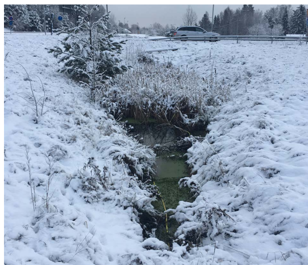
Dike som ombändertar dagvatten norr om väg 276.
