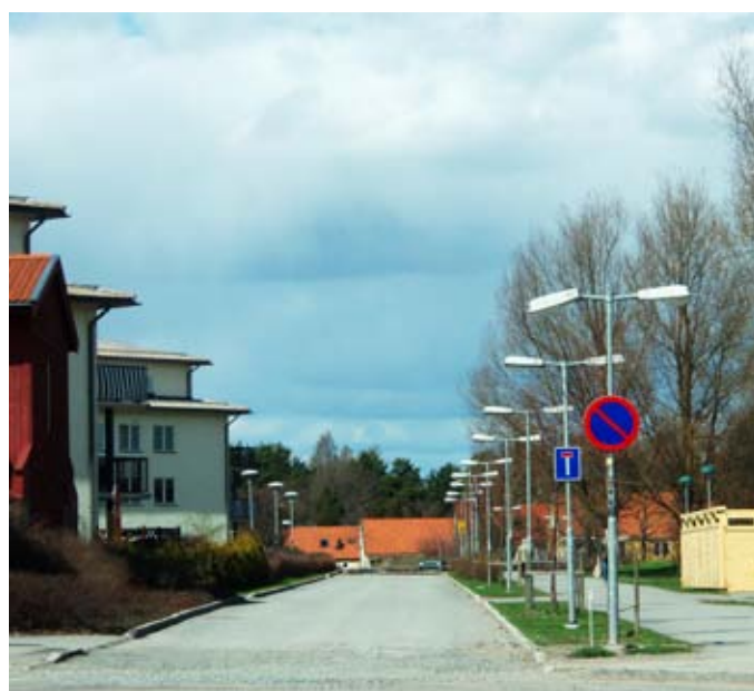
Tegelbruksvägen. Dålig visuell ledning: Samma armatur för gata och gångväg. Här kunde stolpen vara högre för gatuarmaturen, och ha en lägre monterad arm för gångvägen. Foto: Frida Lindström 2010.
