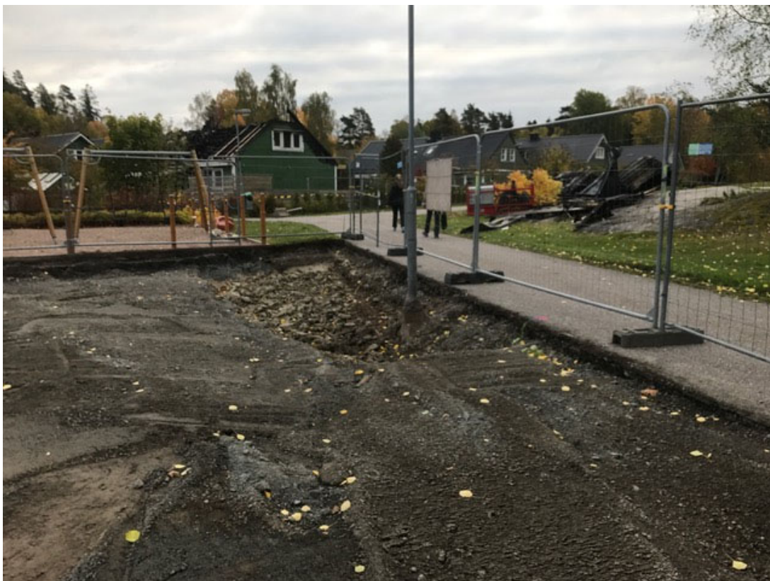
Bild på en av stolparna som ska bytas tillsammans med fundament.
