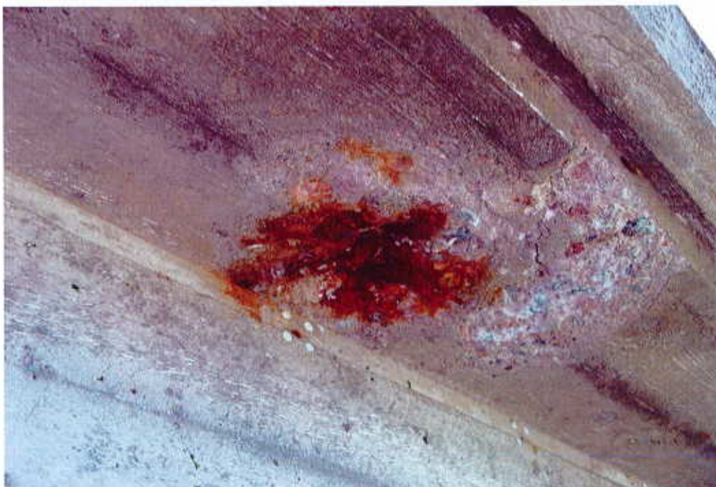
Foto 4. Spjälkning i underyta kantbalk.
