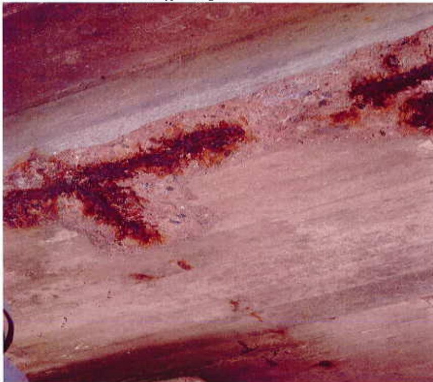
Foto 8. Korrosion på armering i plattans underyta, spjälkning.
