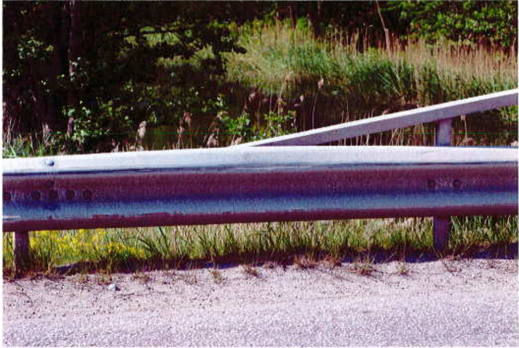
Foto 13. Deformerat räcke, sydväst om bron.
