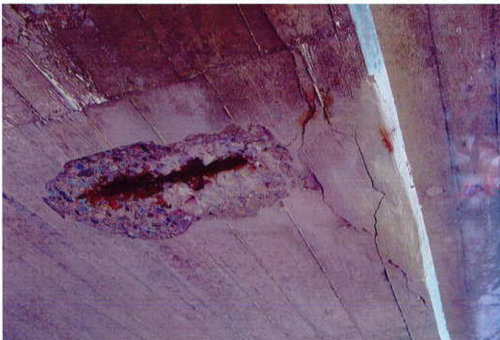
Foto 6. Korrosion på armering i plattans underyta.
