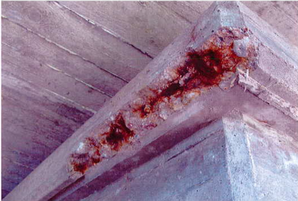
Foto 7 Norra landfästet, spjälkningsskada.
