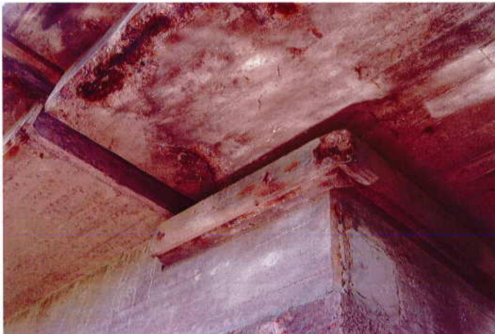
Foto 10 Yta över södra landfästet med bomparti, korrosion på armering med spjälkning som följd
